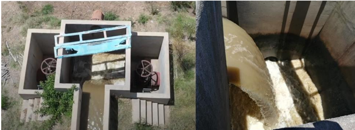
Figura 3 Cámara de derivación de caudales al tratamiento primario
